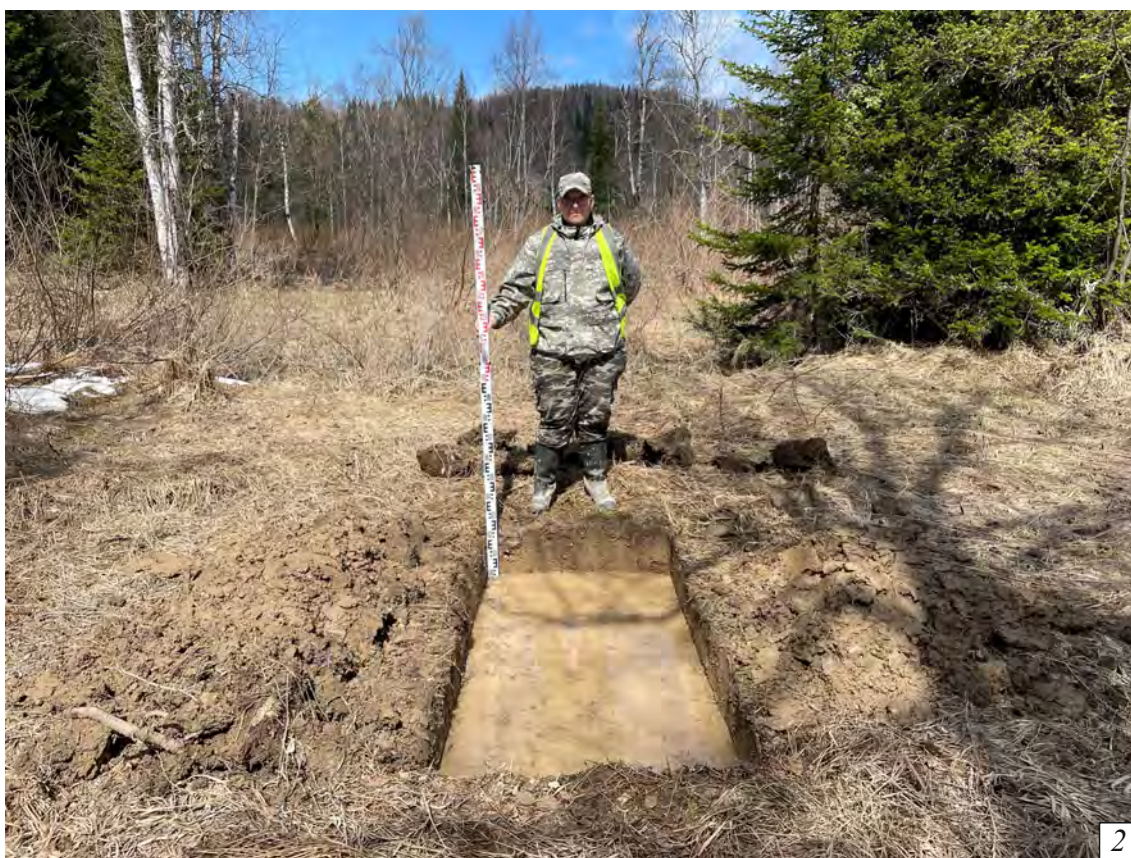
Рис. 49. Археологическая разведка по объекту «Реконструкция каменной трубы на 505 км пк 4 участка Юрга – Таштагол Западно-Сибирской железной дороги» (Российская Федерация, Кемеровская область – Кузбасс, Таштагольский район). Шурф №3. 1 – вид после разметки. 2 – вид после выборки. Везде вид на север.
